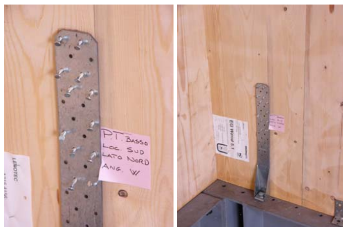
Figura 9. Collasso di un holddown dopo la prova con Kobe 0,9g
